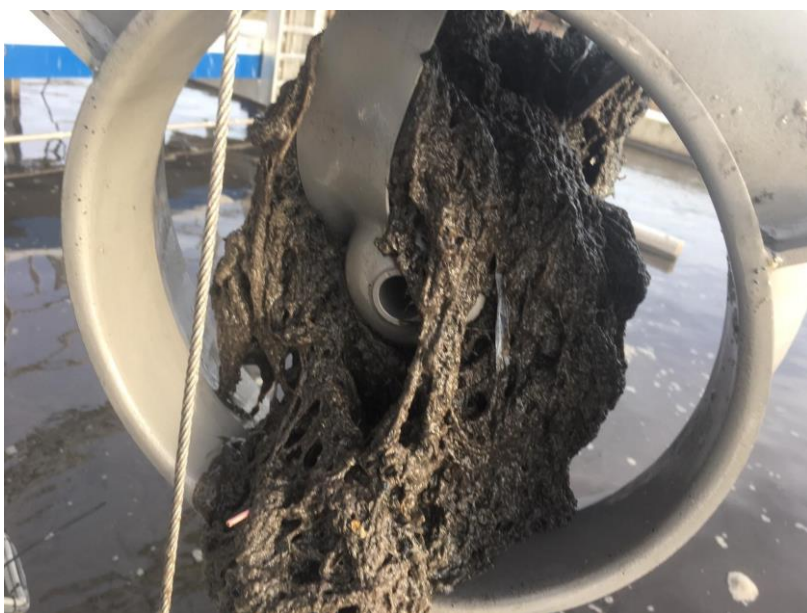
Afbeelding 2. Vervuilde voortstuwer op een rioolwaterzuiveringsinstallatie (Bron: Waterschap Rivierenland)
