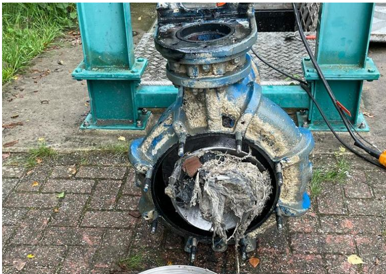
Afbeelding 1. Veelvoorkomend probleem: een op doekjes vastgelopen pomp in een rioolgemaal [Bron: Waterschap Vallei en Veluwe]
